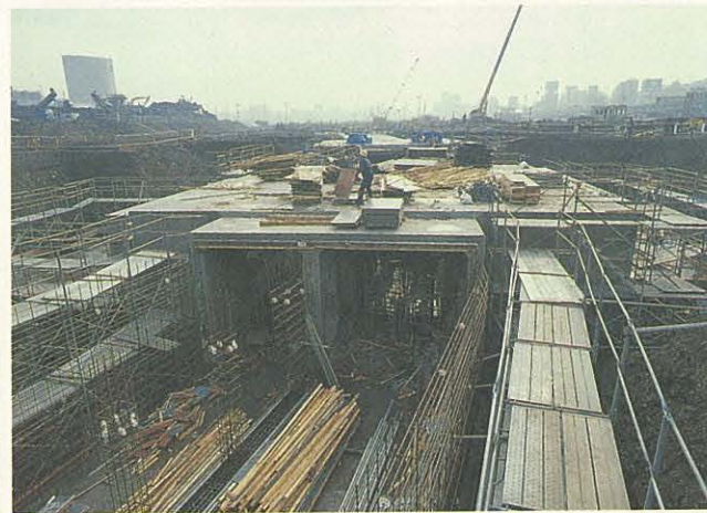
都市基盤施設の整備(共同溝)
