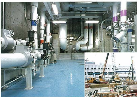
地域冷暖房プラント
