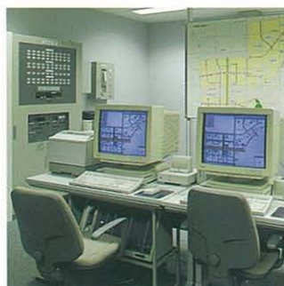
中央監視システム
