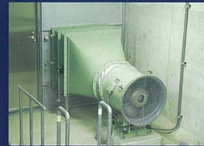
【防災安全設備】 異常温度、誤欠の場合は、新鮮な空気を入れ換える排風機が自動的に作動します。 The fan circulates air when necessary.
