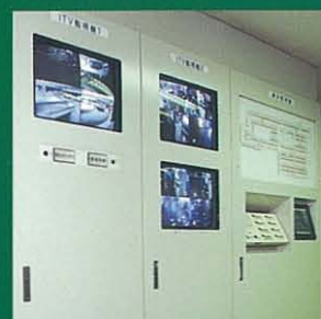
コンピュータ制御盤
