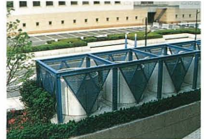
地上の設備機器は植栽等によって隠して下さい。
