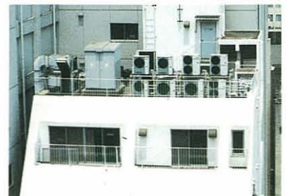
屋上の設備機器が目隠しされていないとこのように雑然とした風景になってしまいます。
