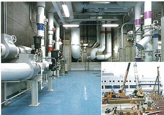
地域冷暖房プラント
